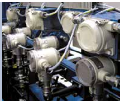
监控氮气压缩机的压力和温度传感器
