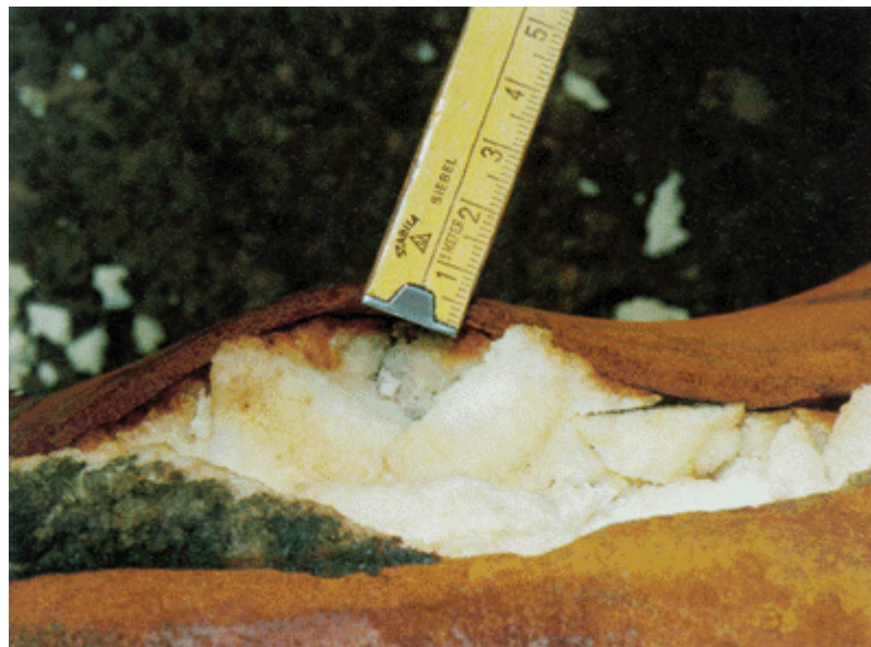
Abbildung 3: Bersten einer Leitung durch popcorn-Bildung
