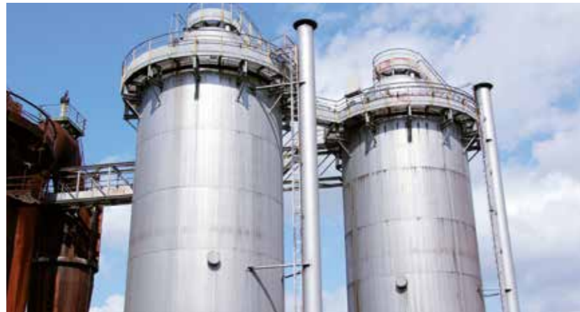
Silo Be- und Entladung
