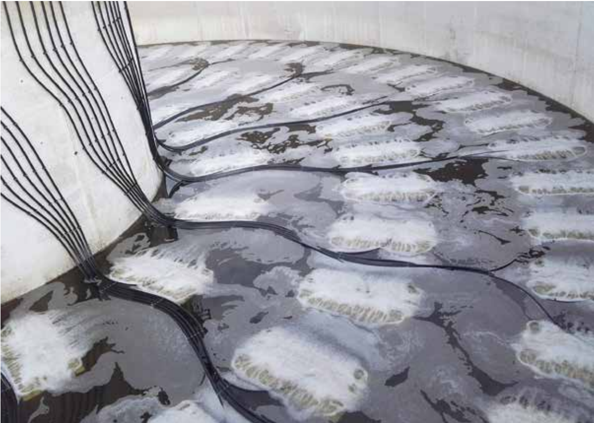
Neue Belüfter sorgen dafür, dass die von den AERZEN Aggregaten zur Verfügung gestellte Luft in das Becken gelangt. Dadurch ist der Sauerstoffeintrag um 50 Prozent höher als mit den alten Kerzenbelüftern.
