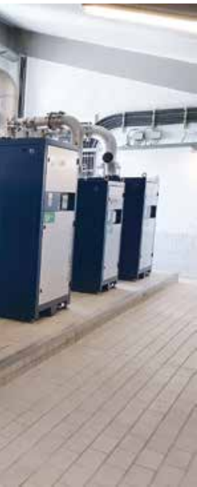
Fünf Turbogebälse von AERZEN sorgen für die Sauerstoffversorgung in den Belebungsbecken.
